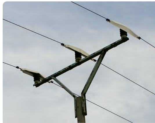
Abb. 6: Mast mit Abdeckhaube
