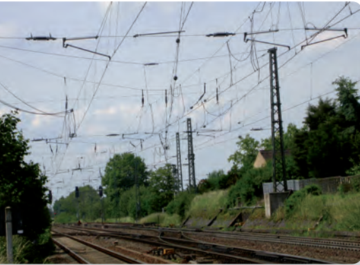
Abb. 3: Beispiel für elektrifizierte Bahnanlagen. Neben der bereits im Naturschutzgesetz verankerten Sicherungspflicht für Mittelspannungsanlagen der Stromversorger muss auch eine Lösung für Bahnstreckengebiete mit hohem Gefährdungspotenzial geschaffen werden.
